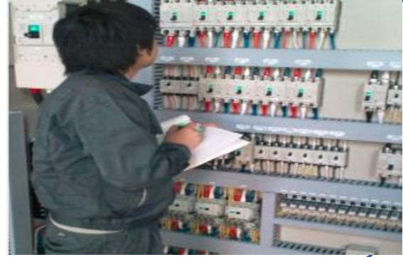
取付機器照合検査風景
