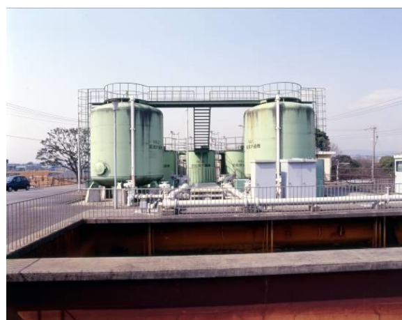
片山浄水所 ろ過機
