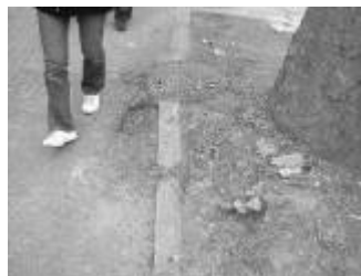
ほそう ろうきゆうか 舗装の老朽化
