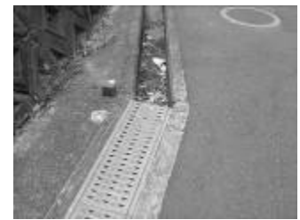
みぞぶた ふ び 溝蓋の不備
