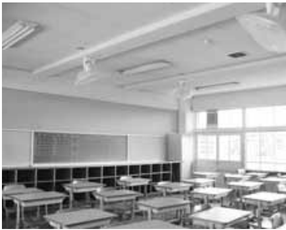
エアコン設置が望まれる教室
