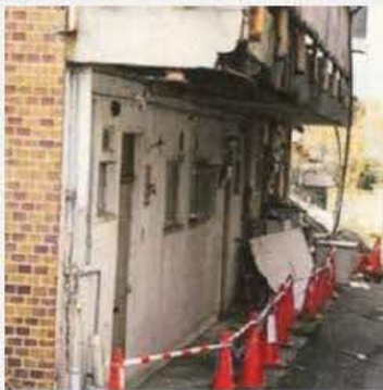
外壁剥落等の危険な状態
