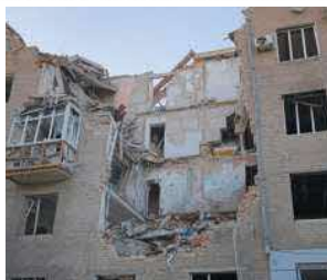
攻撃によって破壊された病院
