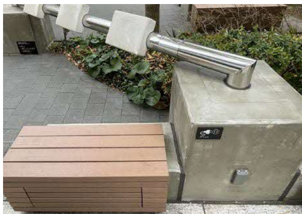
ベンチ併設のフリー電源設備
