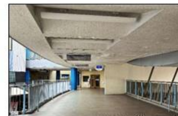
施設の老朽化・陳腐化
