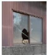
窓が割れた管理不全空家
