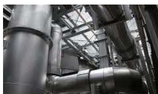
プラント配管
