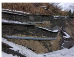
▲ 送水管の被災
