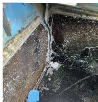
▶ 浄水場沈澱池の 躯体ひび割れ
