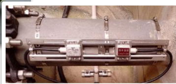
地下水の取水量を計測する水量計
