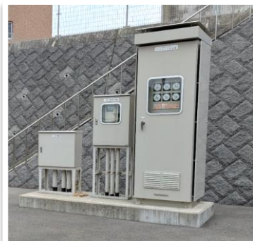
地下水の取水に関する操作盤
