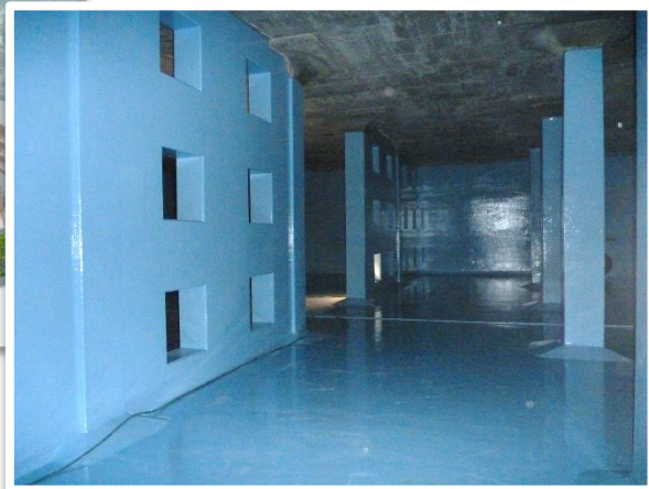
写真7-4 耐震化済みの配水池 (耐震壁)
