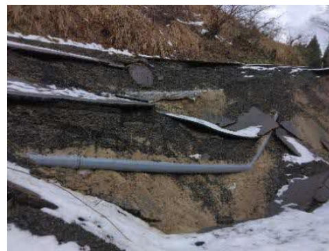
▲ 送水管の被災
