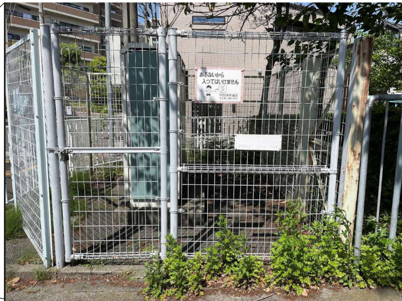
■既存監視装置外観
