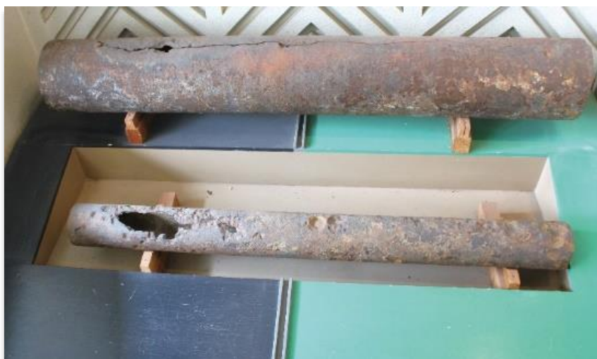
写真7-6 老朽化した水道管
