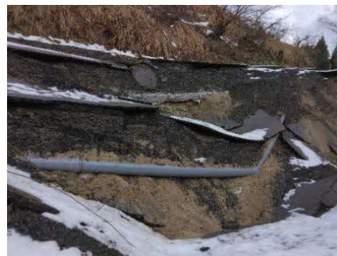
▲ 送水管の被災
