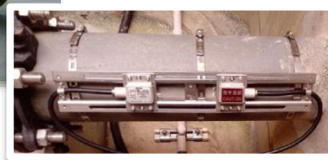
地下水の取水量を計測する水量計
