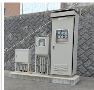
地下水の取水に関する操作盤
