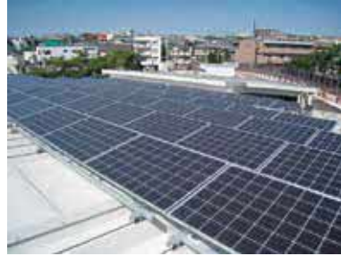
屋根一面に設置された太陽光パネル
