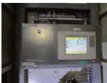
ポンプコントローラを改修し、既存インバータ設定値を見直し、エネルギー効率を改善！
