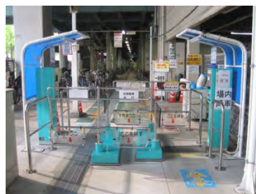
写真 5-37 機械式出入口ゲート（吹田市）
