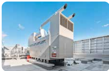
自家発電装置
