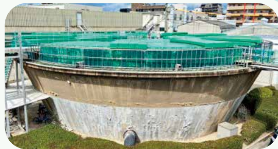
地下水処理施設
