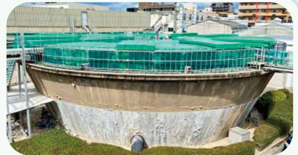
地下水処理施設
