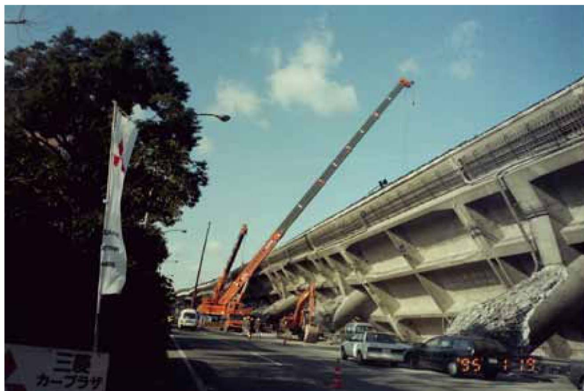
阪神・淡路大震災で倒壊した阪神高速道路
