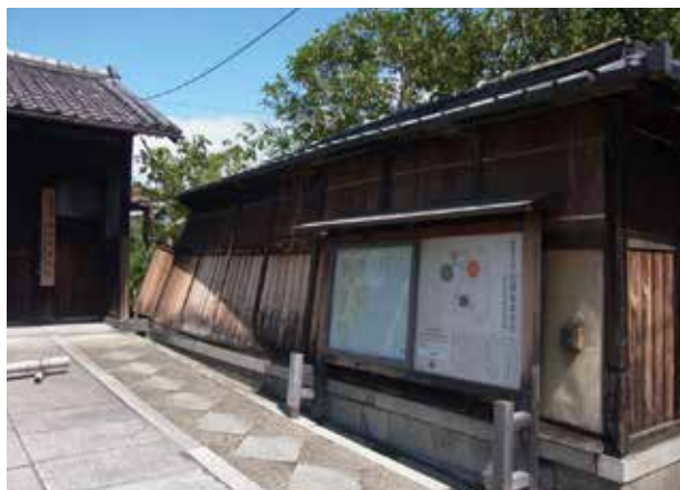
旧西尾家住宅の被害状況
