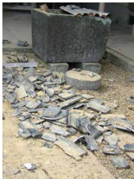
旧中西家住宅の被害状況
