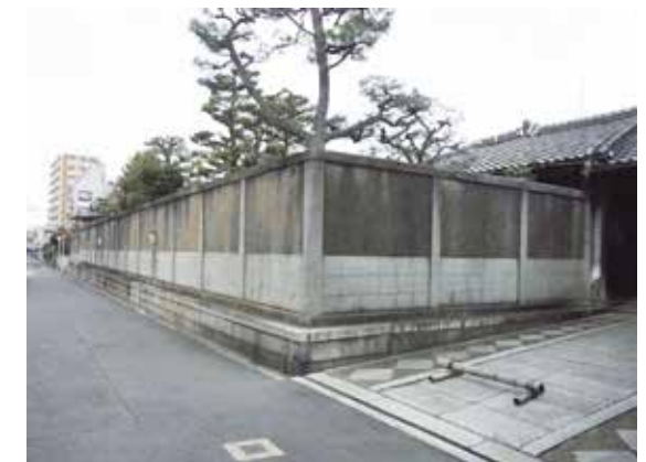
鉄筋コンクリート塀（修理前）
