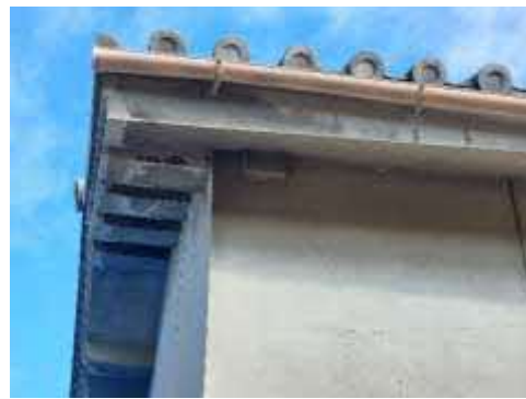
写真 2-1-1-16 内蔵壁の雨染み、亀裂
