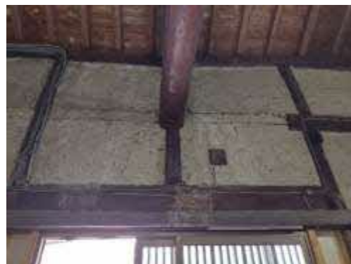
写真 2-1-1-10 長屋門開口部まぐさの腐朽
