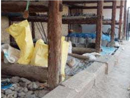
写真 2-1-1-19 キザラ小屋の柱の足元の腐朽
