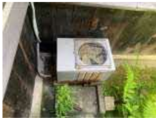
写真 3-2-4-24 中庭・空調設備 1
