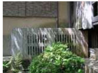
写真 3-2-1-20 空調設備隠し
