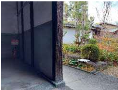
写真 2-1-1-9 長屋門の柱の痩せ
