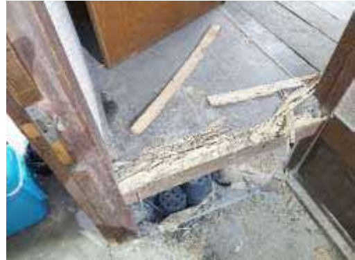
写真 2-1-1-12 男部屋床廻り造作材の破損
