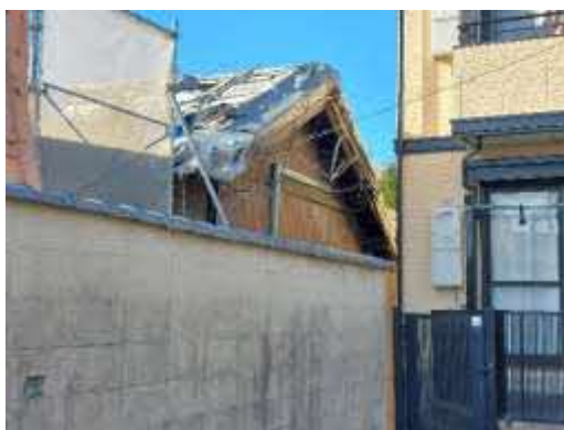
写真 2-1-1-21 井戸屋の屋根の現状
