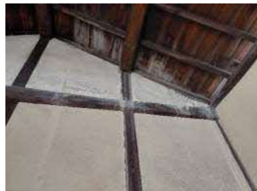
写真 2-1-1-22 雨漏れによる壁・梁の雨染み
