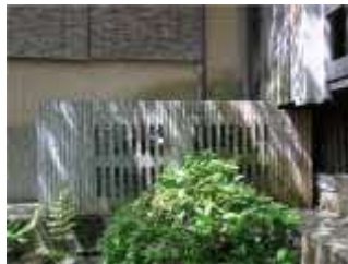
写真 3-2-1-23 空調設備(玄関棟)
