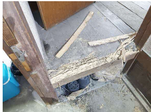
写真 2-1-1-12 男部屋床廻り造作材の破損
