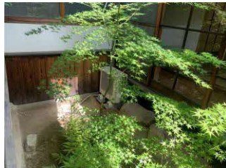
写真 3-2-4-25 中庭・空調設備 2
