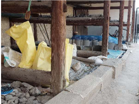
写真 2-1-1-19 キザラ小屋の柱の足元の腐朽
