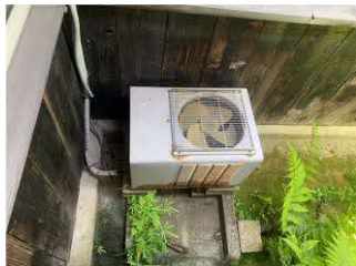
写真 3-2-4-24 中庭・空調設備 1
