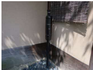
写真 3-2-1-22 防犯設備センサー
