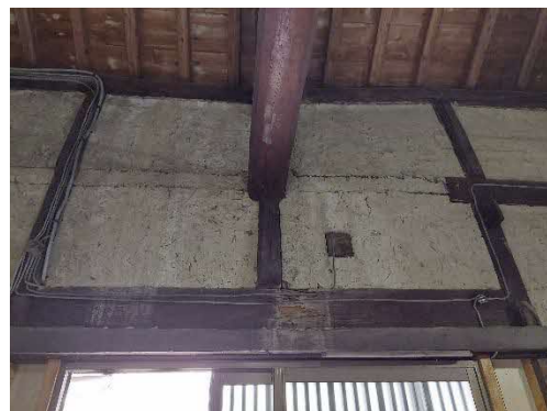
写真 2-1-1-10 長屋門開口部まぐさの腐朽
