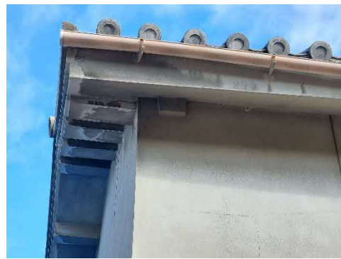
写真 2-1-1-16 内蔵壁の雨染み、亀裂
