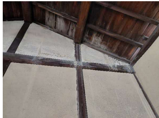
写真 2-1-1-22 雨漏れによる壁・梁の雨染み
