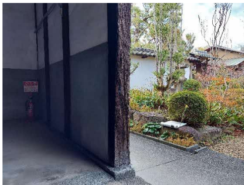
写真 2-1-1-9 長屋門の柱の痩せ
