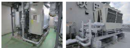
ガス吸収式冷温水発生機！ 空冷ヒートポンプチラー！
