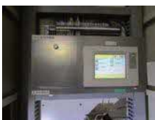
ポンプコントローラを改修し、既存インバータ設定値を見直し、エネルギー効率を改善！
