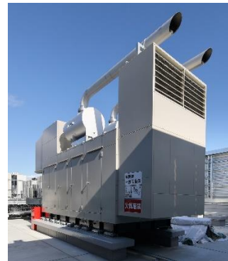
自家発電設備
