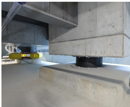
地下 免震装置
