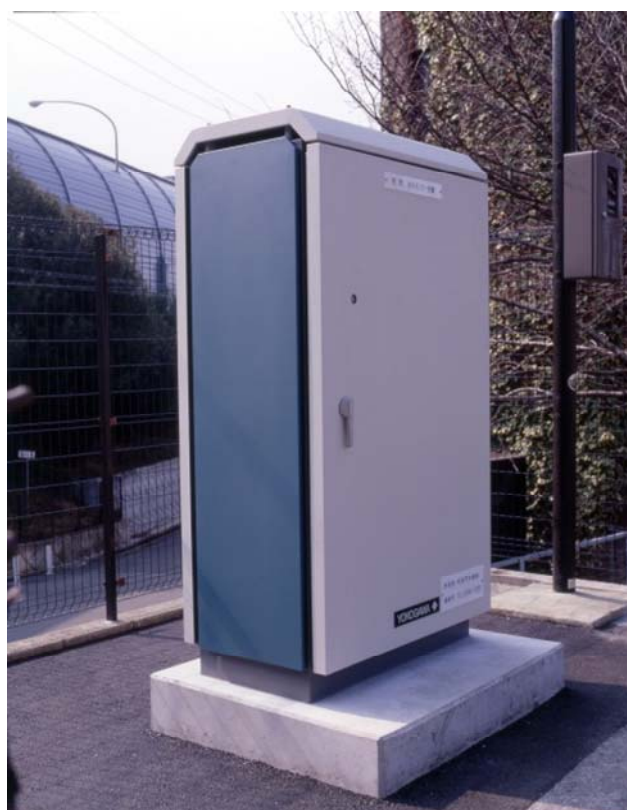
図 2-10-1 自動連続水質監視装置 (祝町公園給水モニター)
