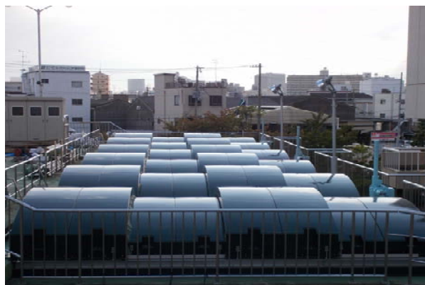
泉浄水所 急速ろ過池
