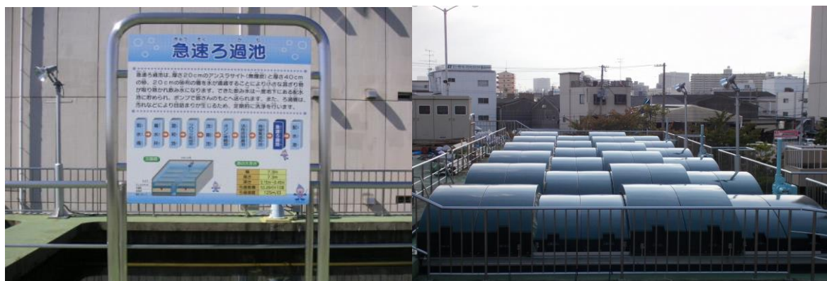
図 8-5-2 泉浄水所急速ろ過池写真
