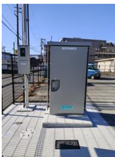
図 2-10-1 自動連続水質監視装置 （山田給水モニター）
