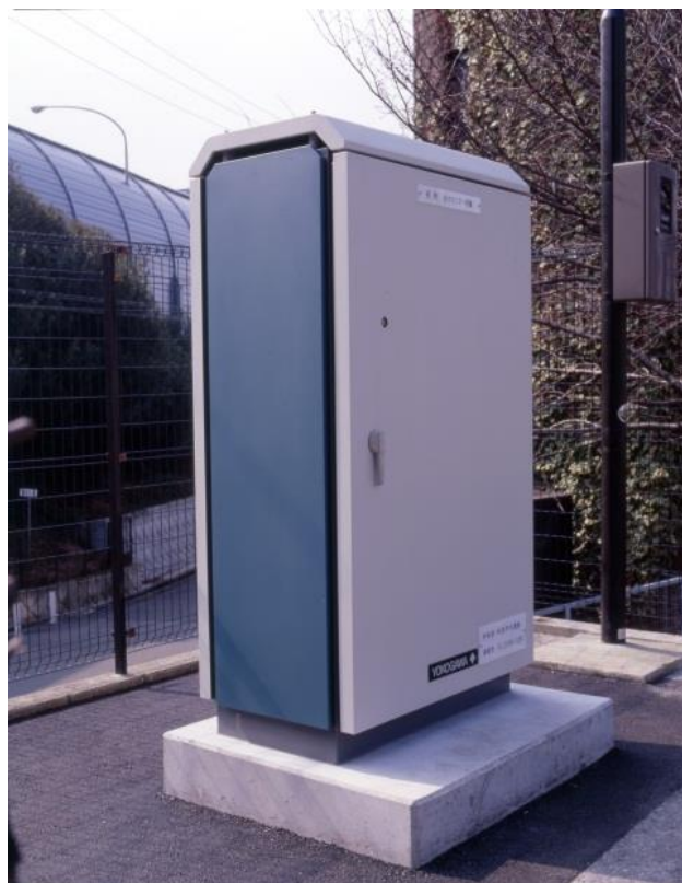
図 2-11-1 自動連続水質監視装置 （祝町公園給水モニター）
