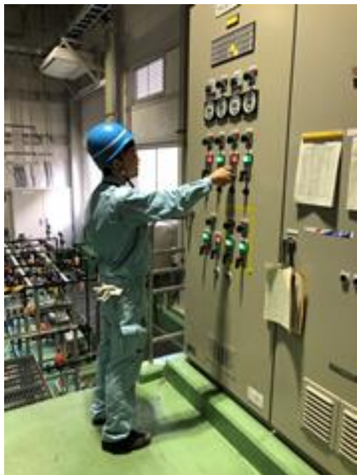
水道施設の保守点検
