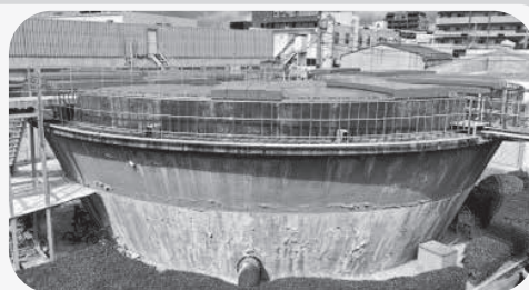
地下水処理施設
