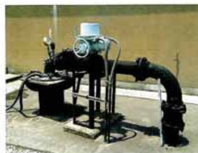
泉浄水所内の深井戸
