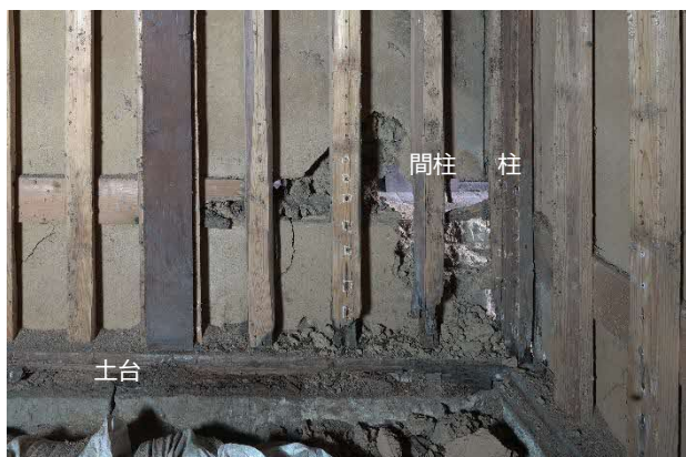
28 柱・土台破損状況 米蔵の足元の木材は破損が著しく、柱の根継補修や土台の取替、地覆石の取替が必要でした。
