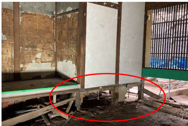
13 男部屋破損状況 北面 男部屋の柱足元は特に破損が著しく、今後、根継ぎ補修を行います。
