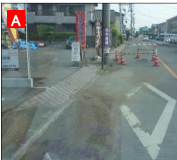
【液状化による砂の噴出跡など】 道路上に砂が噴出し、地下埋設物の一部が隆起していた。
