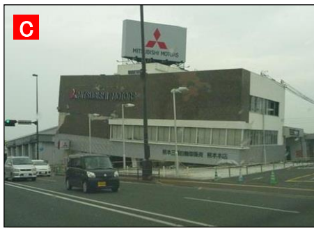
【三菱自動車ディーラーの熊本本店】 車が通行する1階部分のスペースが、倒壊により無くなっていた。
