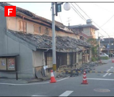
【家屋の被害(宇土市内)】 屋根の瓦が道路に落ちて、前面道路が通行止めになっていた。
