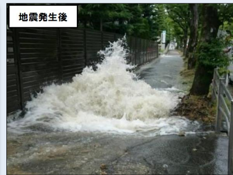
水道管の地震被害
