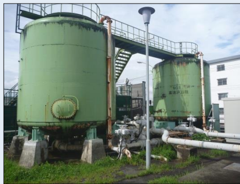
老朽化した施設（片山浄水所）
