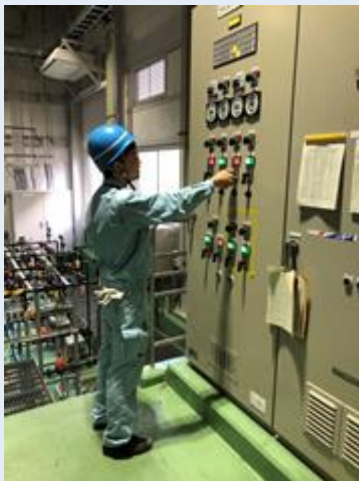
水道施設の保守点検
