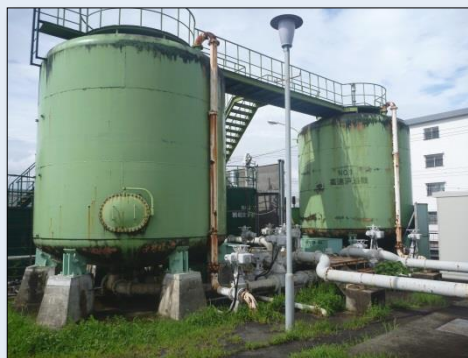
老朽化した施設（片山浄水所）
