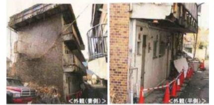
外壁、手すりが崩落した事例
