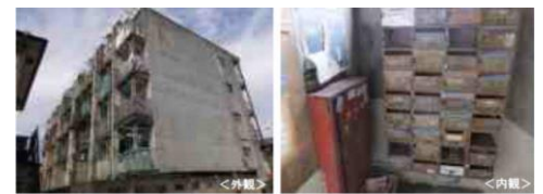
建物の傷みが著しく外壁の剥落、鉄骨の露出などが見られる事例
