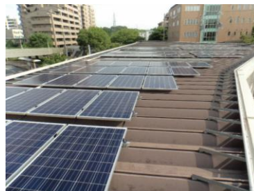
屋根貸しによる太陽光発電システム設置 （阪急山田駅前西自転車駐車場）
