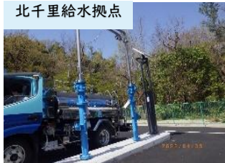
北千里給水拠点
