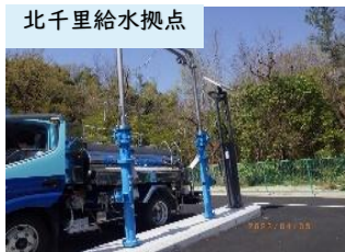
北千里給水拠点
