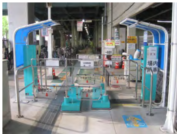
写真 5-37 機械式出入口ゲート(吹田市)
