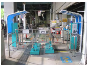
写真 5-37 機械式出入口ゲート(吹田市)
