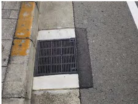
写真 5-6 グレーチング蓋の格子間隔を狭め、滑り止め加工している例（大阪市）
