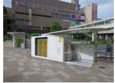
写真 3-13 機械式地下自転車駐車場 (阪急南千里駅)
