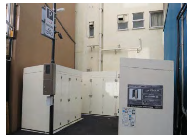
写真 5-32 スポーツ自転車専用ロッカー（東京都中央区）
