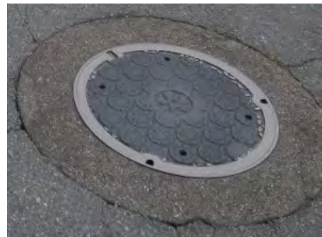
写真 5-7 マンホールの蓋に滑り止め加工をしている例（京都市）
