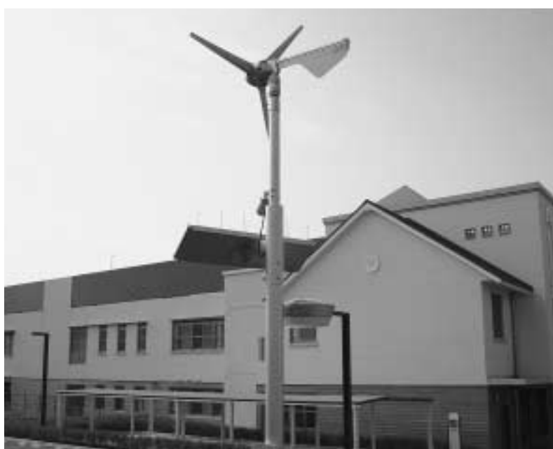
こども支援交流センターに導入された風力発電
