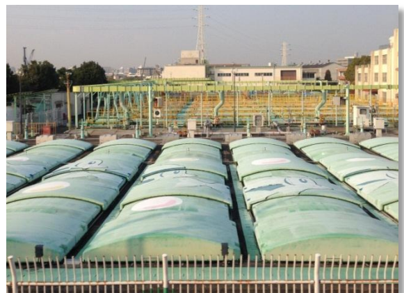
川面下水処理場（川岸町）
