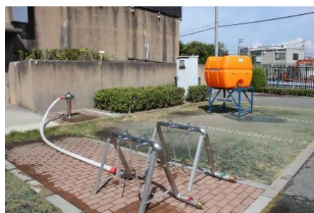
災害時応急給水用設備
