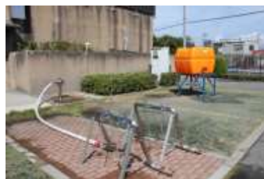
災害時応急給水用設備 (泉浄水所)
