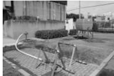
災害時緊急給水用設備 (泉浄水所)
